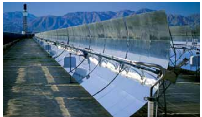
拋物面反射太陽能熱發電站
